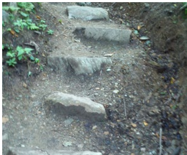
Perte de sol minéral sur le côté dû au manque d'empierrement Les marches ne couvrent pas la pleine largeur de l'aire de marche
